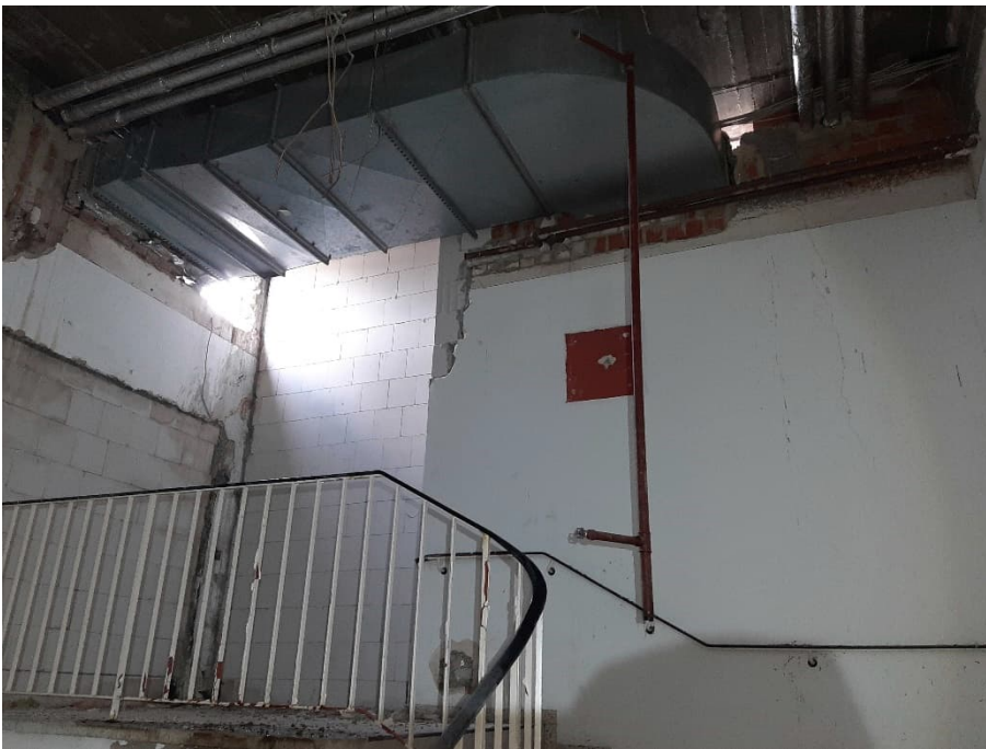
Foto 12: Dachgeschoss des Bestandstreppenhauses mit großen Einflugmöglichkeiten.
