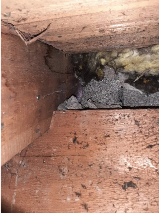
Foto 7: Potenzielle Durchschlupfmöglichkeit für Zwergfledermäuse zwischen Mauerwerk und Dachbalken (Obertorstraße 37).
